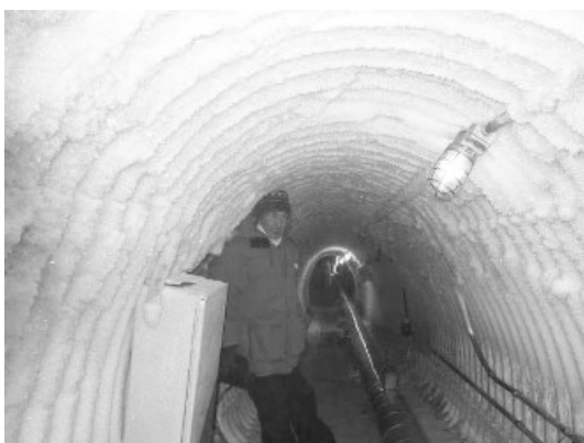
Тоннель с круглым сечением. Вода горячая и холодная, электричество, горячее, газ, отходы — все эти трубы проложены в тоннелях
